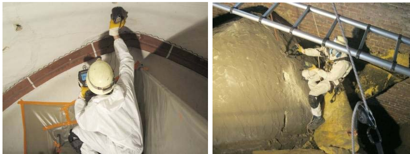
Abbildung 5. Links: Ultraschallechomessungen von der Gewölbeunterseite von einem Gerüst aus; Rechts: Ultraschallechomessungen von der Gewölbeoberseite mittels Seilsicherung, Glaswolle wurde vor den Messungen entfernt
