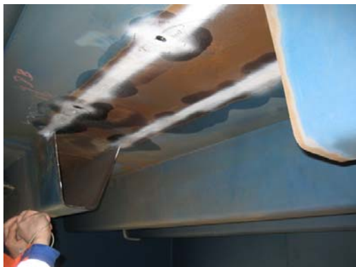
Abb. 6. Ausgeklinkter Bereich einer Trapezsteife. Durch Magnetpulverprüfung wurde sichergestellt, dass das Deckblech frei von Rissen ist.
