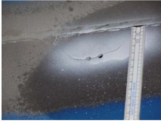
Abb. 4. Risswachstum an der Schweißnaht zwischen einer Trapezsteife und dem Deckblech. Der Riss ist zum Teil in die Steife hineingewachsen. Das „Abbohren des Risses“ blieb erfolglos.
