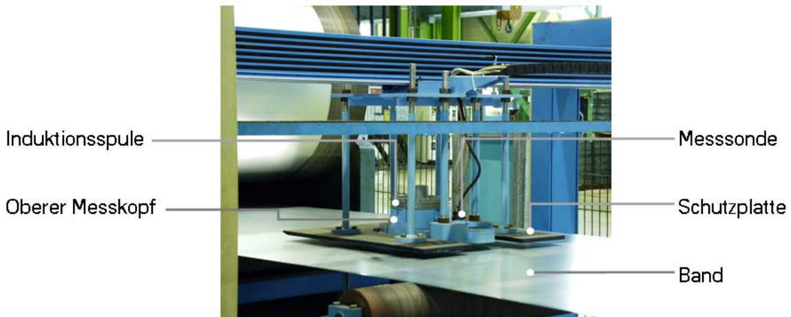
Abbildung 1: Foto eines IMPOC-Messkopfes in einer Feuerbeschichtungsanlage im Online-Messbetrieb.
